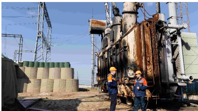
Mitarbeiter von Ukrenergo vor einem von einer Drohne getroffenen Transformator in der Zentralukraine. Bildquelle: KfW Bildarchiv / Jonas Wresch.
